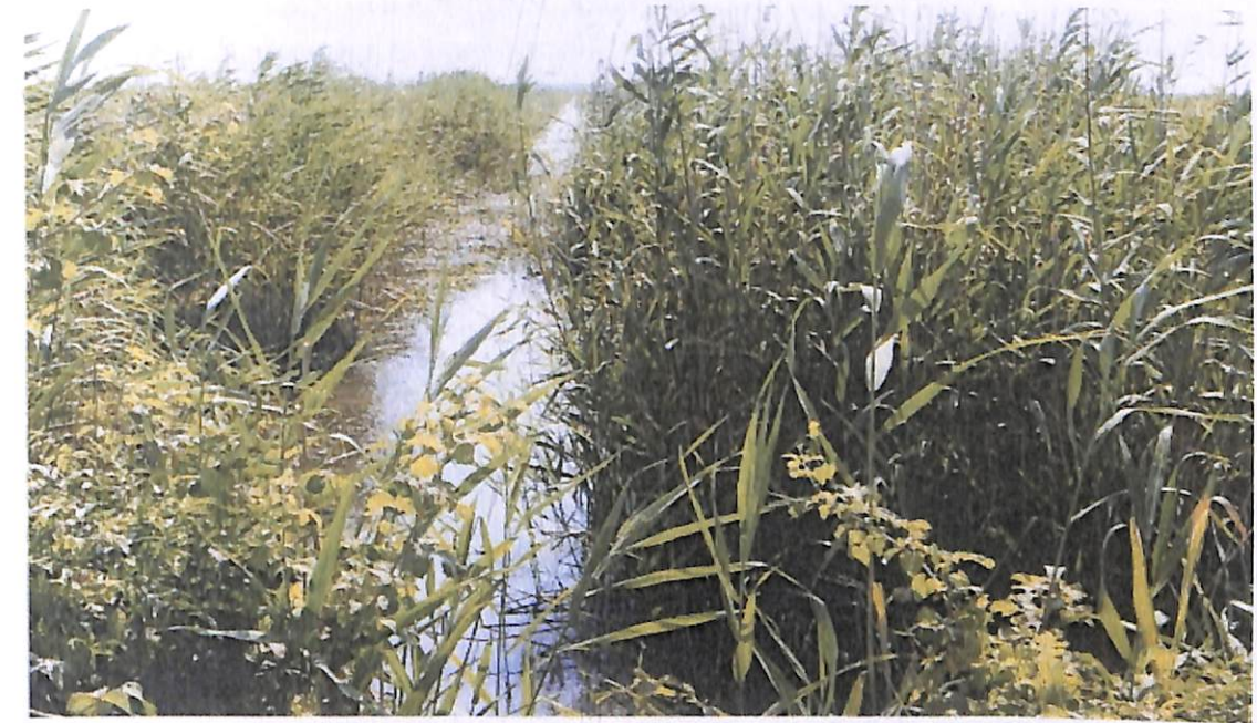
Şək. 3. Tədqiqat ərazisində drenaj şəbəkəsinin vəziyyəti
