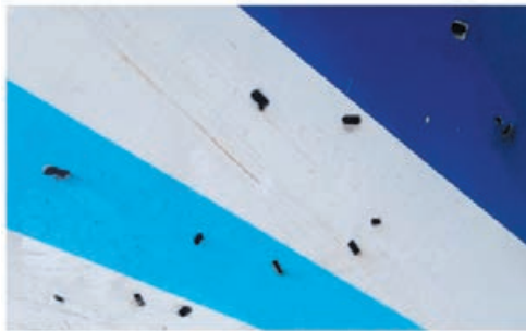
Fig. 11. Повреждения левой стороны горизонтальной части
