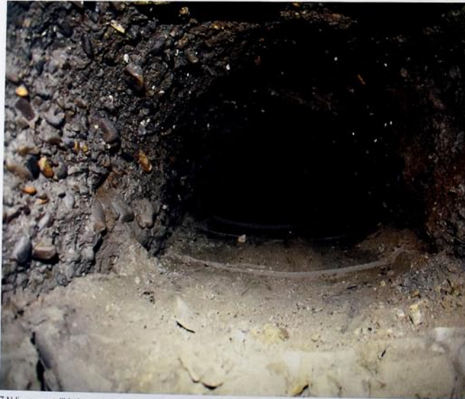
7 N-li quyunun dibində qeydə alınan tunel Tunnel detected at the bottom of the pit No.7
