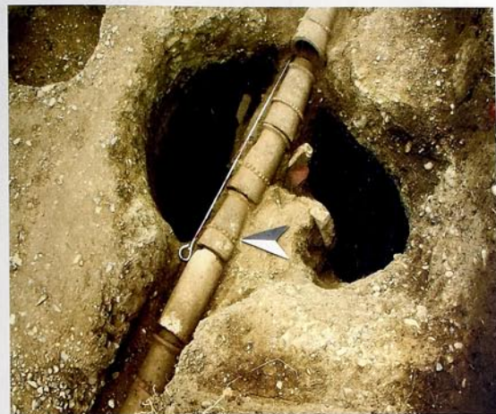
Boru xəttinin çökması The collapse of the pipeline
