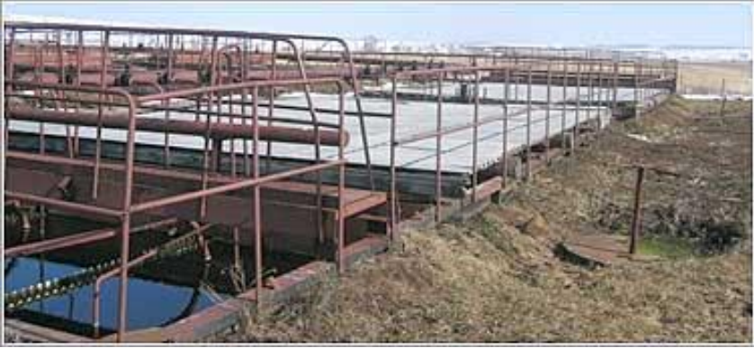
Şəkil 10.42. Minsk Aerasiya Stansiyası (AS)
