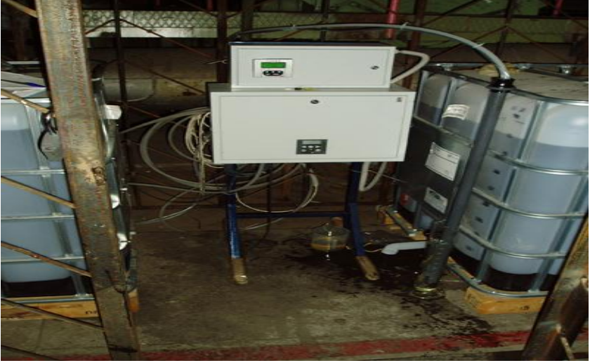
Şəkil 3.17. İstilik şəbəkəsinin əlavə su ilə qidalanmasının korreksion emalı üçün duz çöküntülərinə qarşı reagentin mütənasib dozalaşdırılması stansiyasının xarici görünüşü
